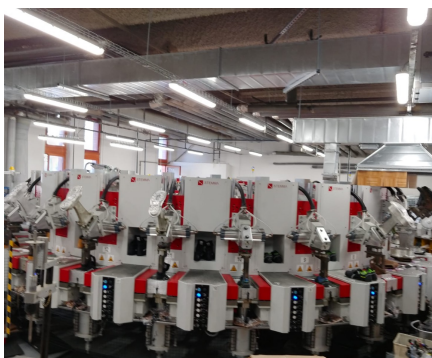
Instalace nového vstřikolisu STEMA
